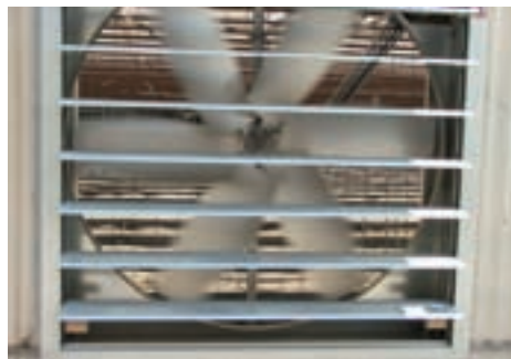
Ventilation fan (pad and fan cooling)
